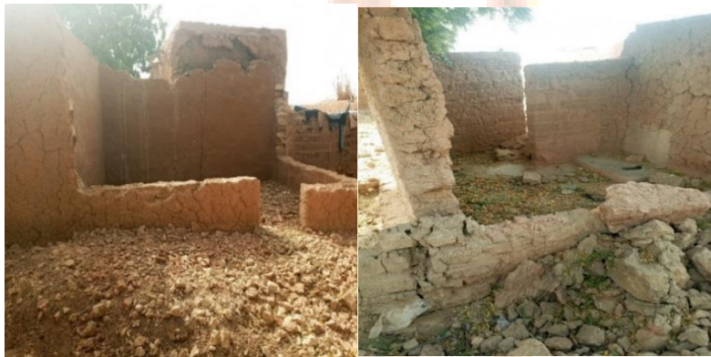
Photo 1 : infrastructures détruites par l'inondation
