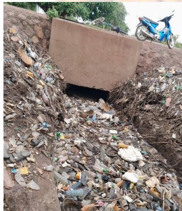
Photo 2 : caniveau obstrué près du château (RN6)
