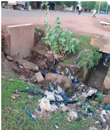
Photo 1 : caniveau obstrué sur la route de san (RN6)
