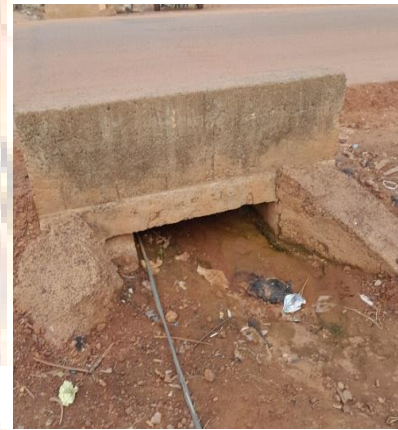
Photo 3 : caniveau obstrué près de l'espace Orange Mali (RN12)
