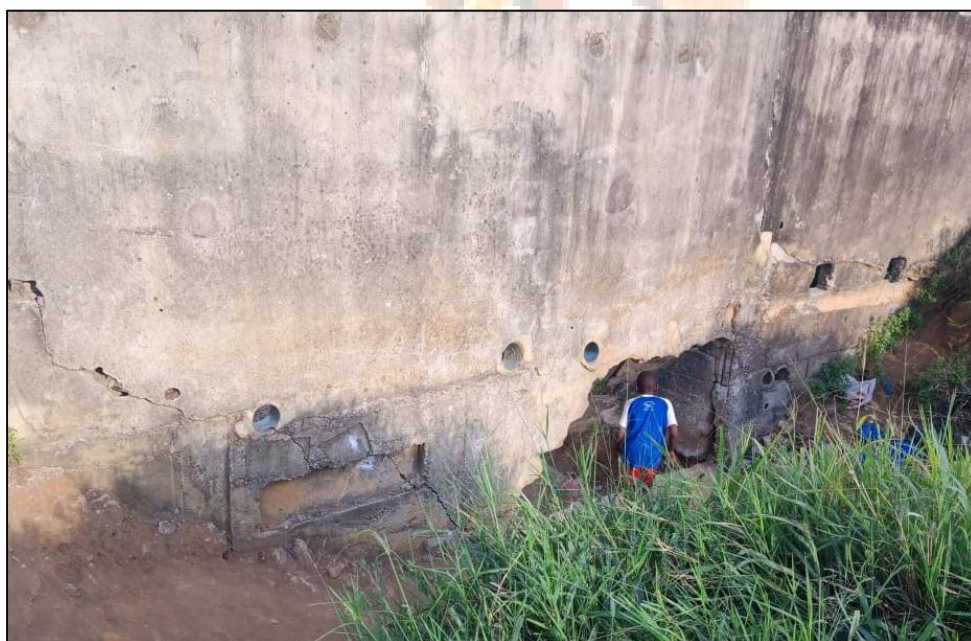
Photo 1: Dégradation de la clôture du lycée municipal d'Adjamé Williamsville favorisant un accès non contrôlé à l'établissement (Cliché : Kablan et al., janvier 2026)
